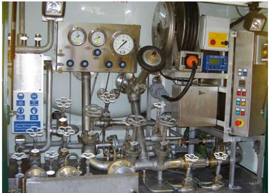
Steuerpult mit den neuen HEROSE Schiebern. Tieftemperatur-Schieberfamilie 09340 (Abb. r.)
