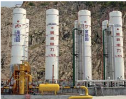
LNG storage tanks in China
