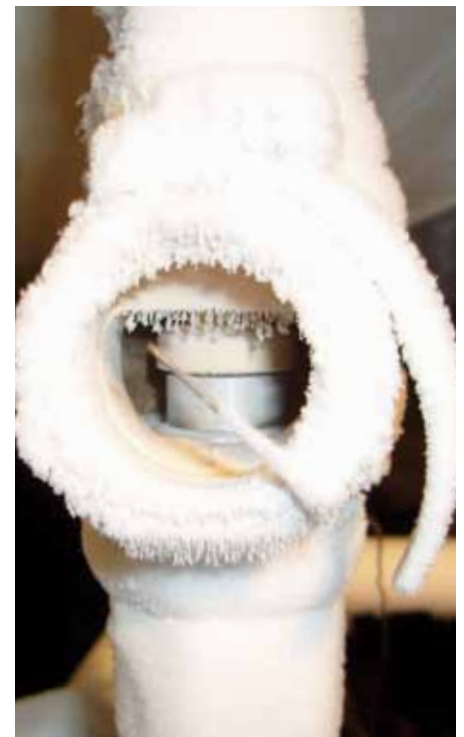
Vereister Austritt des Sicherheitsventils nach 4 Std. mit Temperaturfühler
