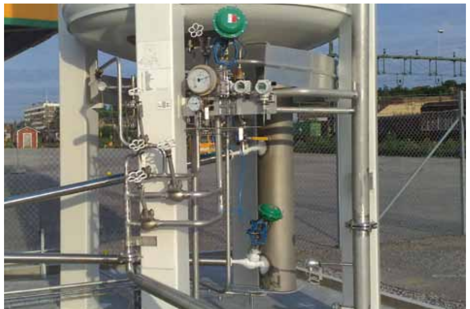
Sundsvall: HEROSE-Armaturen am Biogastank
