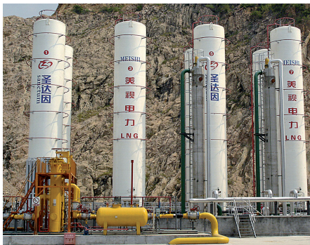
LNG-Lagertanks in China
