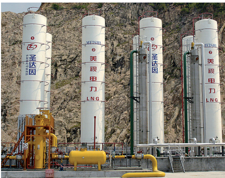
LNG storage tanks in China
